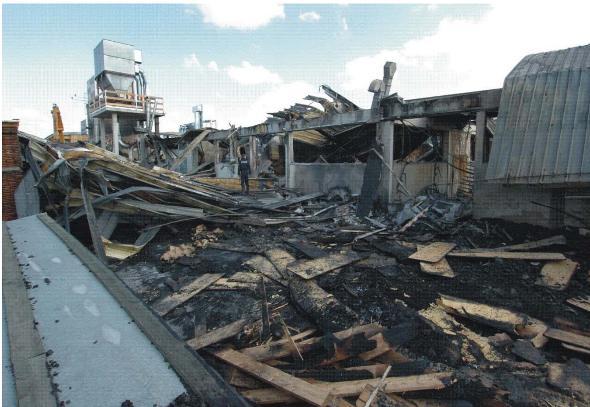
Zerstörte ungeschützte Hallenkonstruktion und fehlende Brandabschnitte führten zu einem Totalschaden (Foto: FF Weiz).
